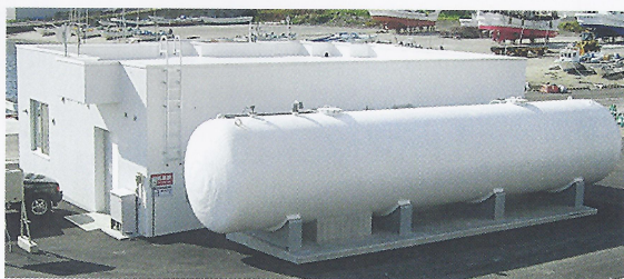
「海洋深層水の貯蔵タンク」（羅臼町）↓
