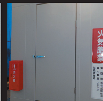
消火器・危険物表示看板
